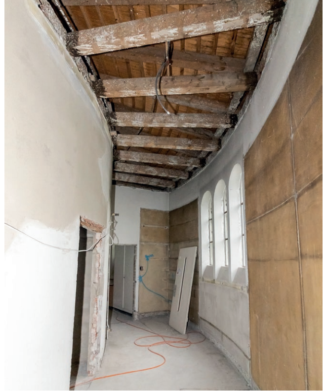
Unvorhergesehene Überraschung: Die Decke in der Sakristei musste zur Überprüfung des darüberliegenden Hohlraums entfernt werden.
